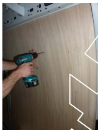
Placez et vissez les deux parties du Côté AR Droit 21 vis 4x30
